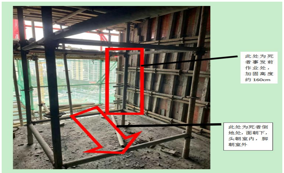
图 2 珠池新村三旧改造项目 1 栋 15 楼事故现场
